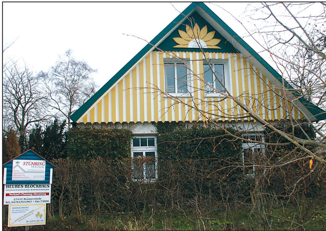
In Frankenborstel bei Zeven entstand diese bildschöne und einmalige Giebelsanierung. Foto: im
